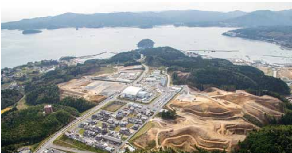
(仮称)南三陸病院・総合ケアセンター着手時の志津川東地区造成状況
